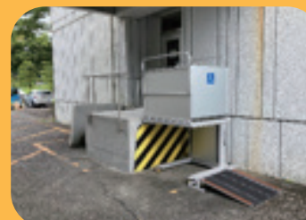
設置された車いすで入れる昇降機
